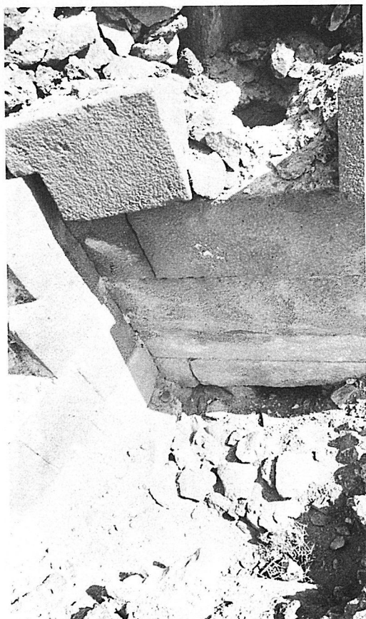
1. Abfluss neben dem Nordost-Turm
