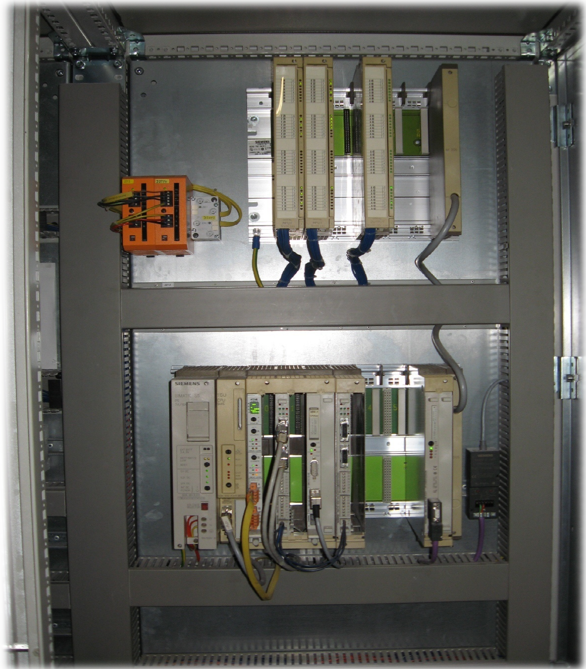
Abbildung 3-5 genutzte S5 Baugruppen (Schaltschrank Steuerung VSG1)
